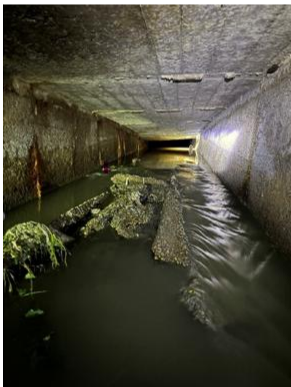
Rue d'Aygue Rouye - Aqueduc existant avec radier explosé
