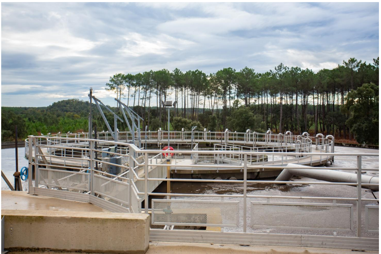
Station d'épuration de SOUSTONS : 100 000 EH
